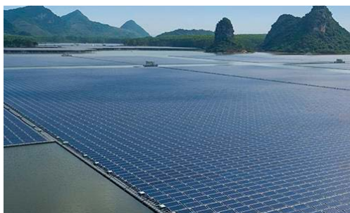
广西贵港灌溉用水库水面漂浮电站
