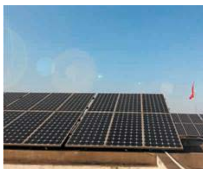
大港股份屋顶电站
