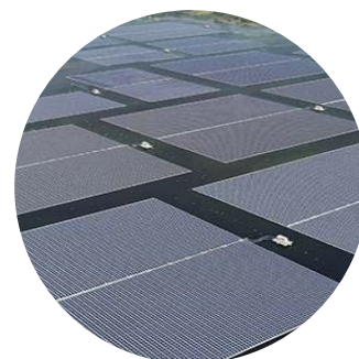
水面光伏发电系统
