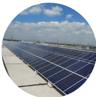
屋顶光伏发电系统
